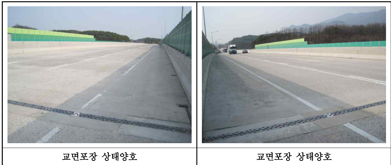
【사진 25.3.43】 교면포장 손상현황
