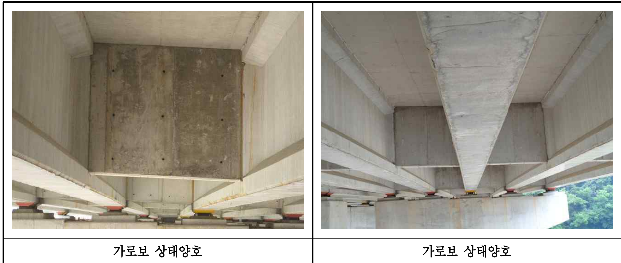
【사진 25.3.30】 가로보 손상현황
