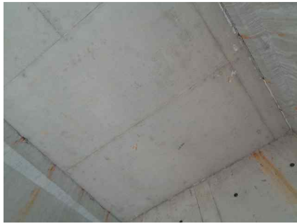
S3 바닥판하면 망상균열(2.5m×4.0m)
