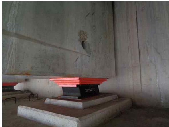
S1-G4 거더 인양홀 파손(0.2m×0.2m)
