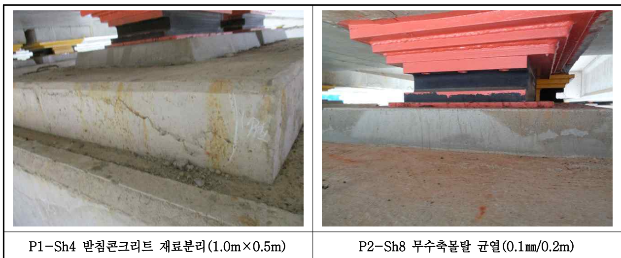
【사진 25.3.36】 교량받침 손상현황
