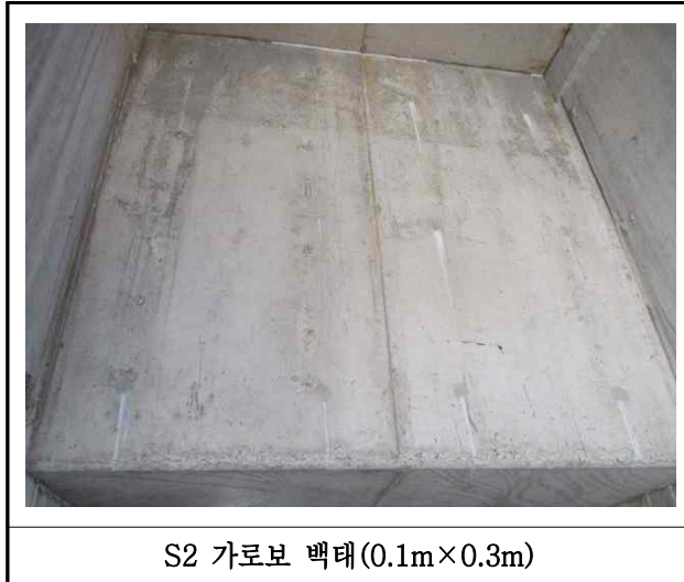
【사진 25.3.7】 가로보 손상현황
